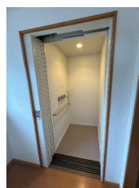
1階エレベーター
